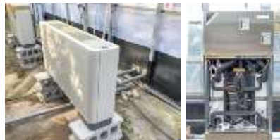
ハウス内を暖房する室内機 地中熱ヒートポンプ
