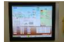
遠隔監視制御対応のモニター
