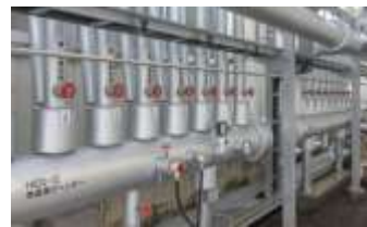
地中熱ヒートポンプに熱源水を配給するヘッダー
