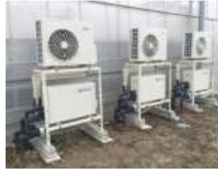
50mの高設苗床16床の温度を3台の地中熱ヒートポンプ(空気熱とのハイブリッド方式)で制御。
