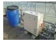
地中熱ヒートポンプ
