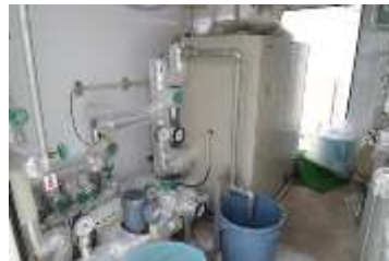
地中熱ヒートポンプ
