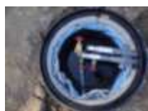
地下水熱交換タンク（340L）
