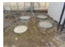
地下水熱交換タンク
