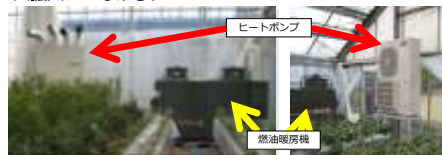
ヒートポンプと燃油暖房機のハイブリッド運転
